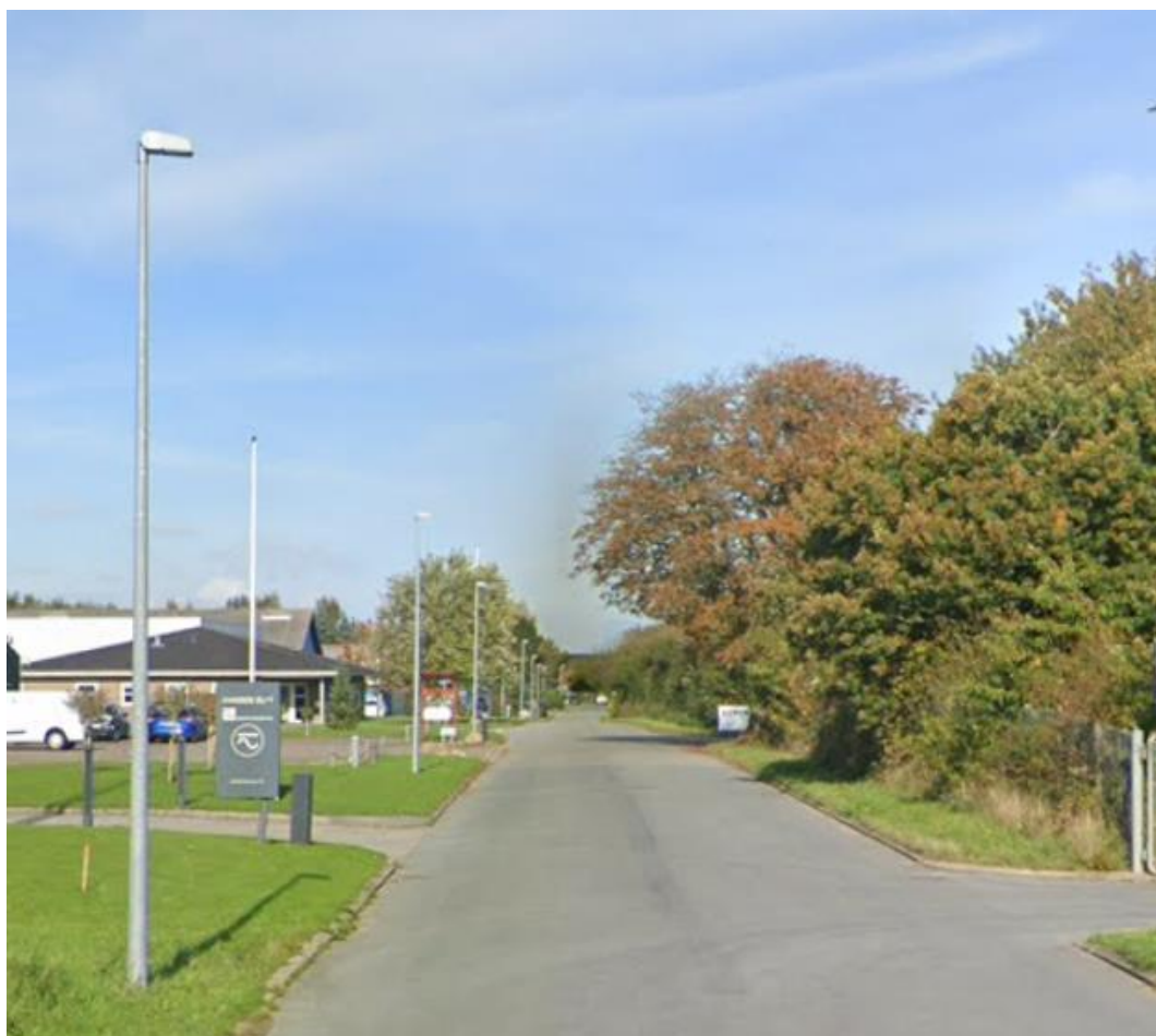
Håndværkervej – 7 m koniske master placeret 1m bag kørebanekant – Thorn Civiteq armatur er topmonteret
