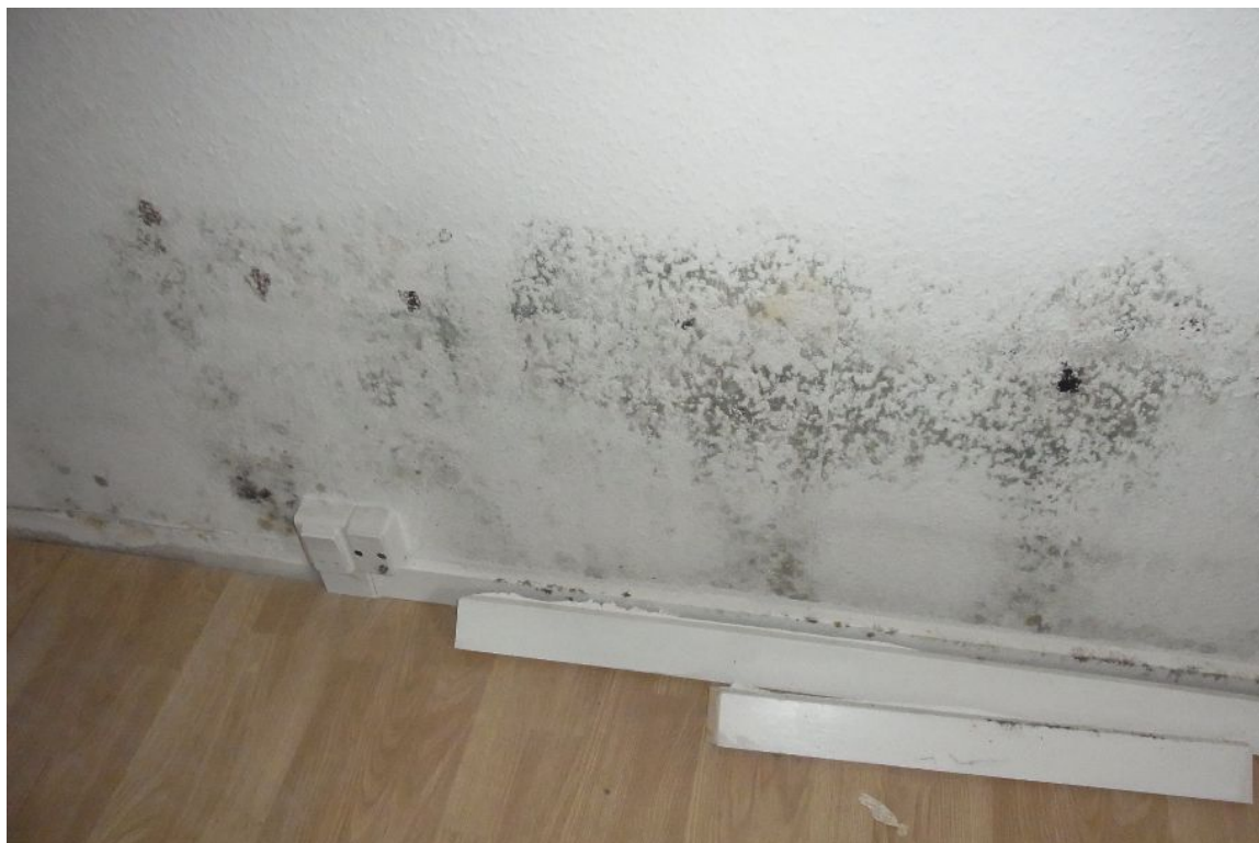
Skimmelvækst på gavlvæg i soveværelse – Aftrykssted nr. 1
