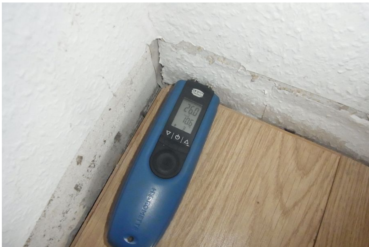
Fugtmåling på 26% i forsatsvæg på gavl, soveværelse
