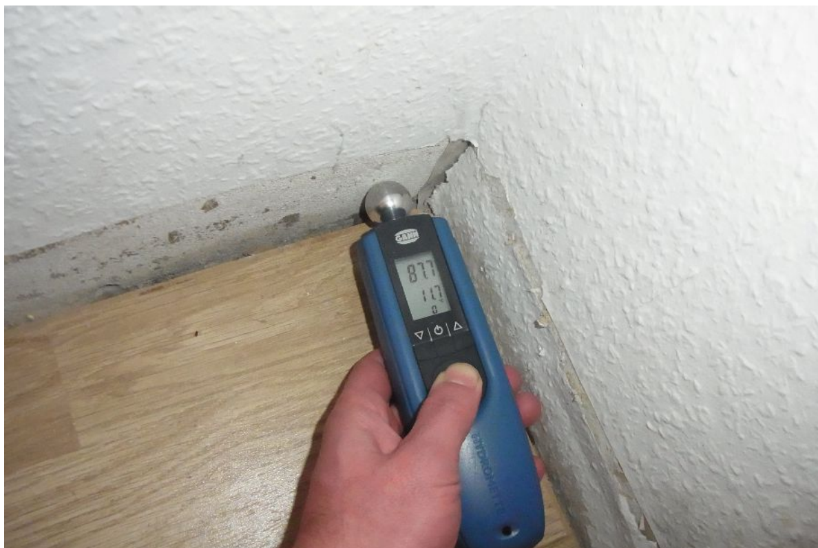
Fugtmåling på 87 digits i skillevejg tilstødende gavl, soveværelse
