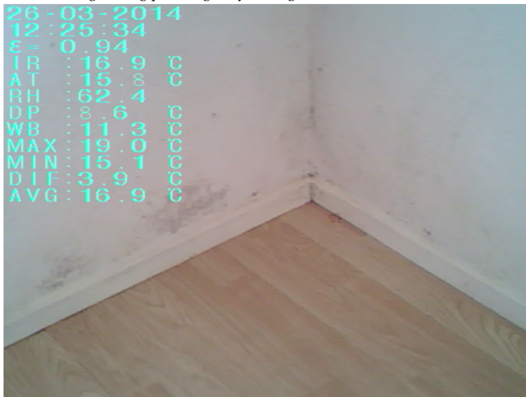
Relativ luftfugtighed på 62%, kuldebro på 3-4°C i ydervæg, nordvendt børneværelse
