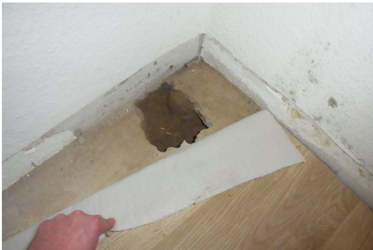
Kraftig opfugtning under terrændæk, soveværelse
