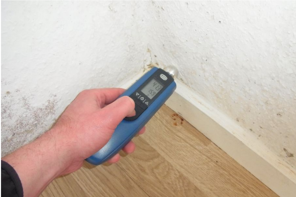
Fugtmåling på 41 digits i ydervæg, nordvendt børneværelse
