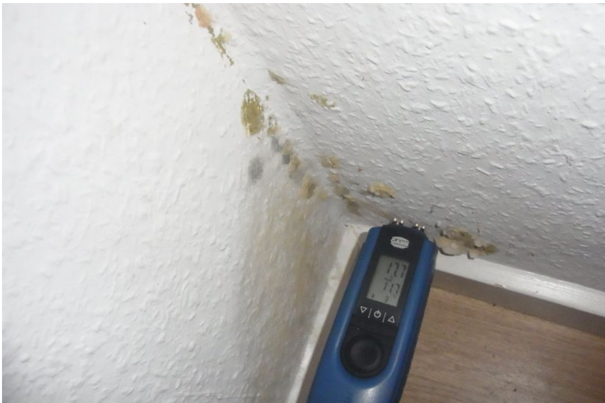
Fugtmåling på 17% i facadevæg, skimmelvækst på forsatsvæg, soveværelse
