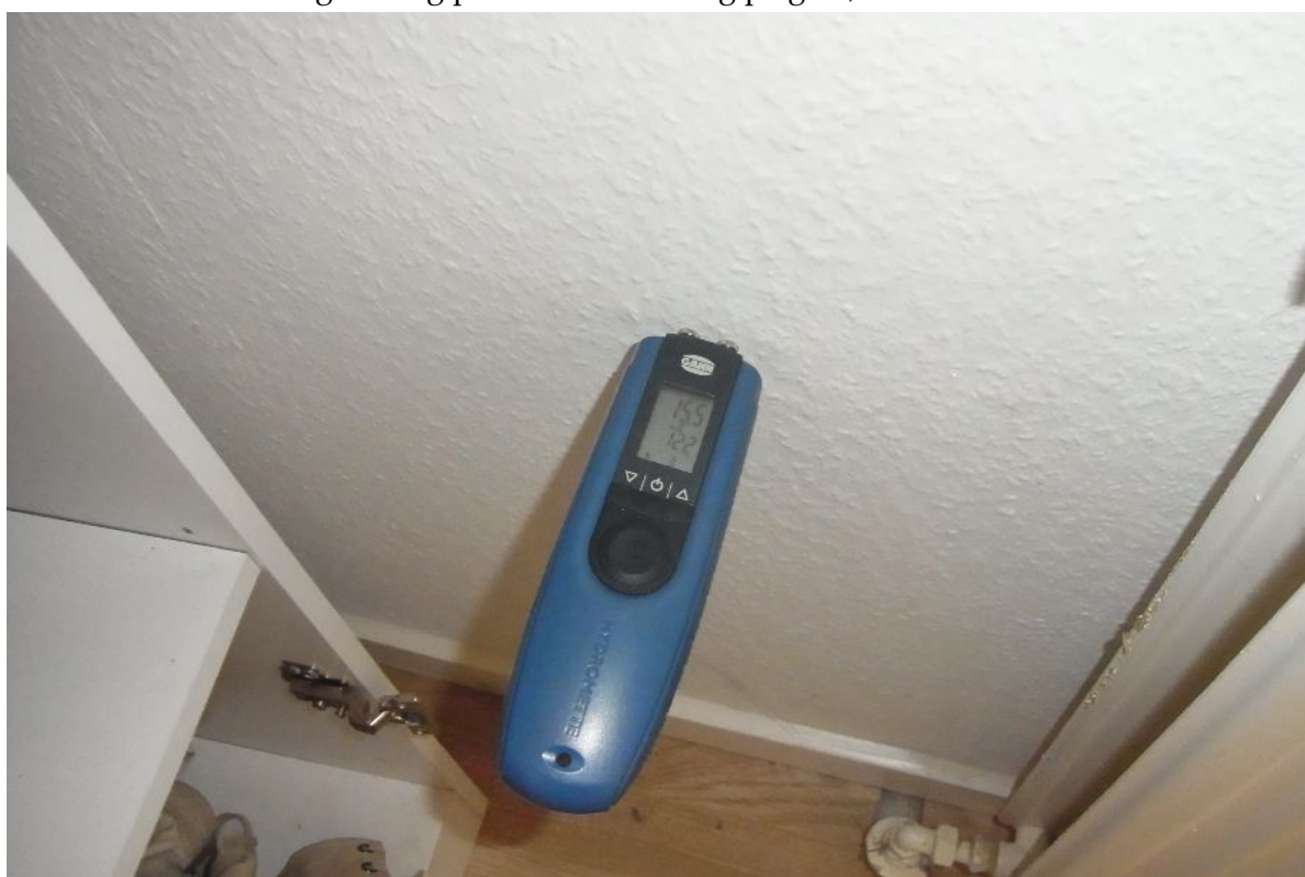
Fugtmåling på 15% ca. 50 cm over gulvniveau, soveværelse
