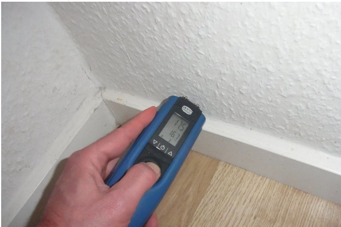
Fugtmåling i loft på 17% i forsatsvæg på gavl, sydvendt børneværelse
