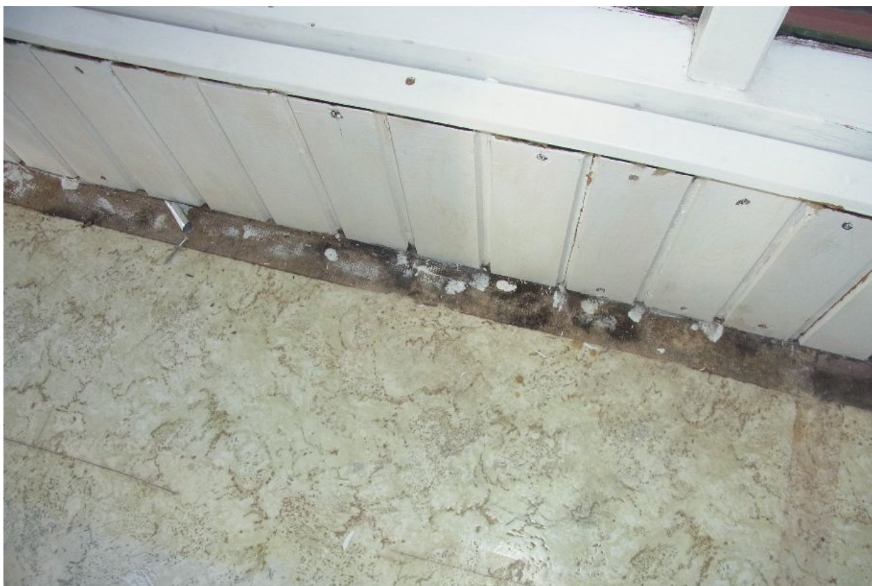
Skimmel og fugtskader i udestue
