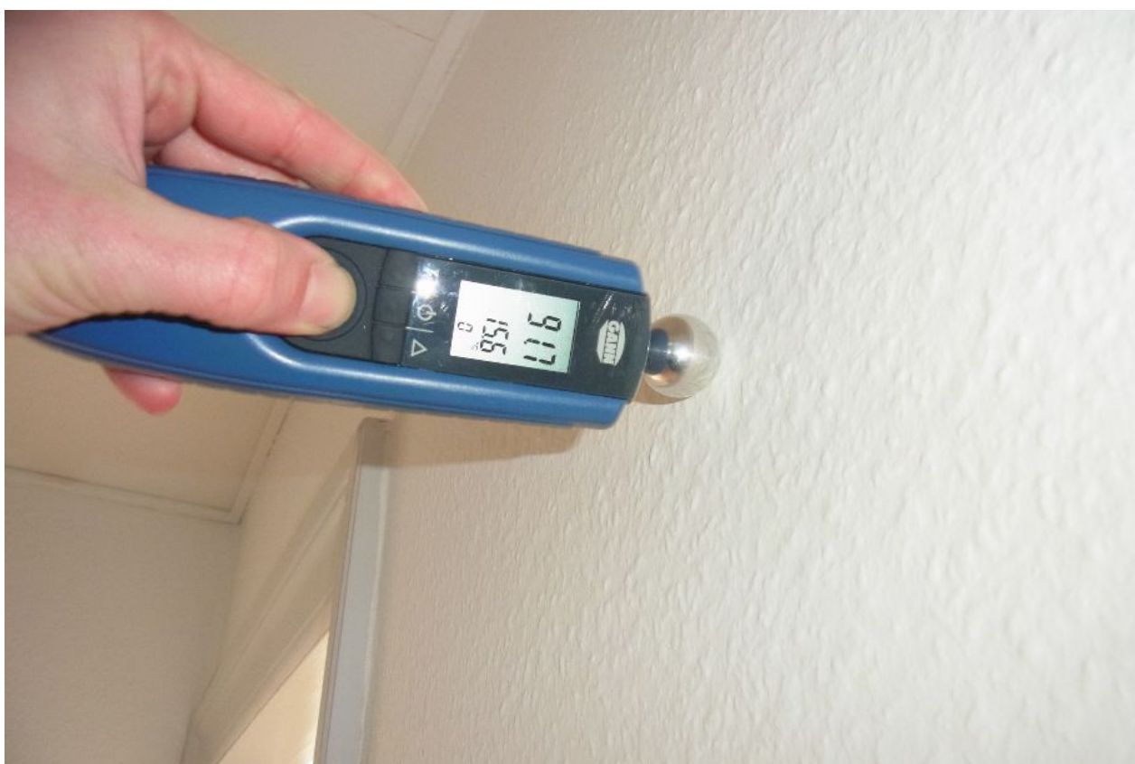
Forhøjet fugtindhold i murværk tilstødende skorsten
