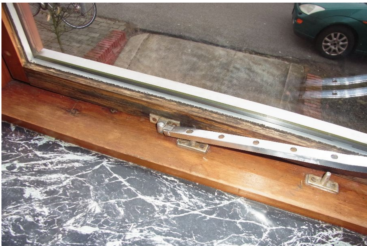
Fugt og vækstområder på vinduer i stueplan
