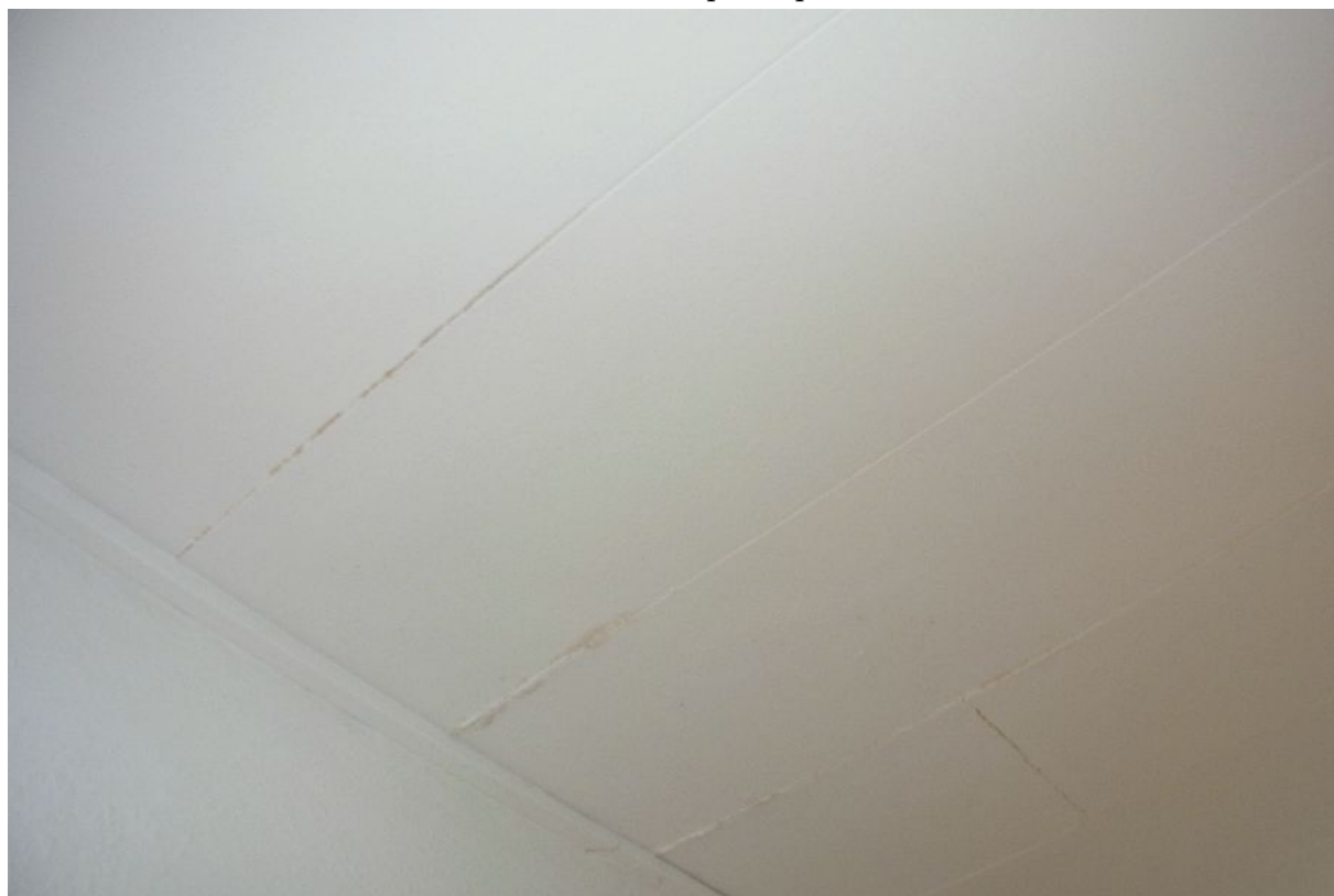
Fugtskade omkring skorsten, gang, 1. sal
