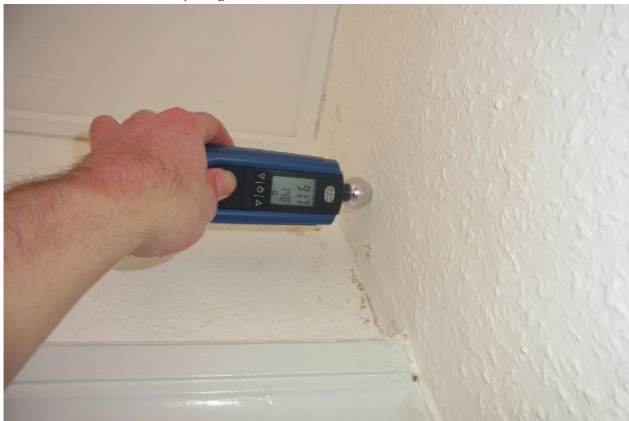
Forhøjet fugtindhold i murværk tilstødende skorsten
