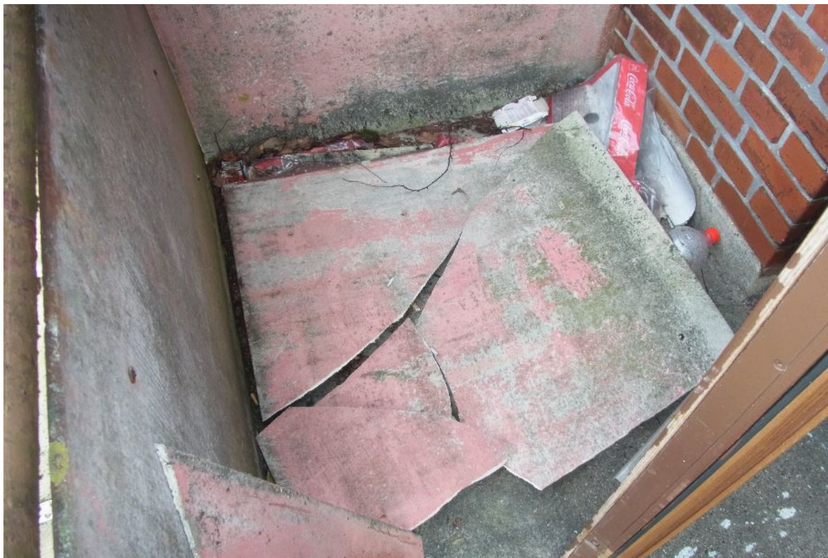
Brudt asbestplade på altan
