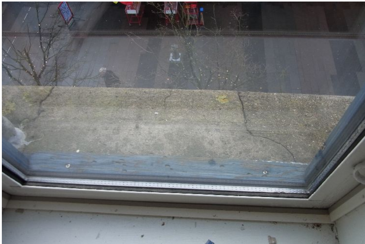
Revner i sålbænk ved vinduesparti
