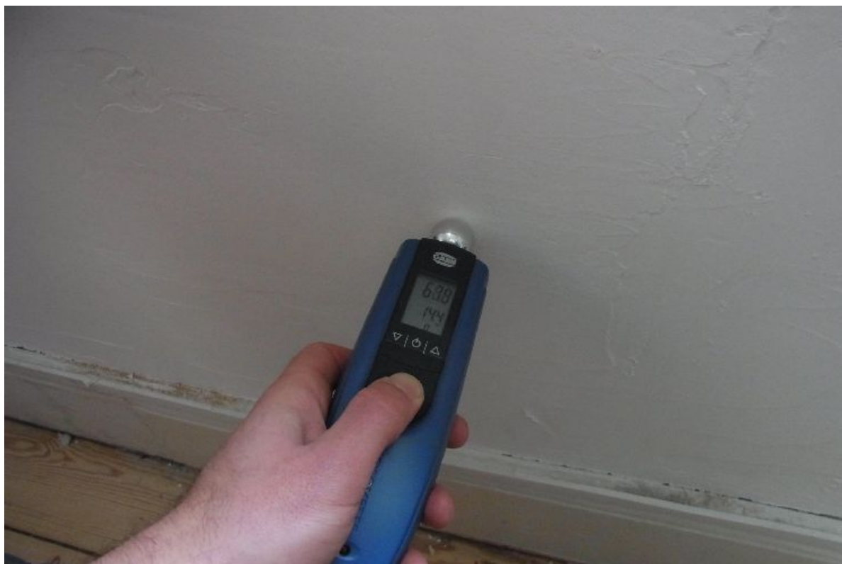
Fugtmåling på 69 digits, ydervæg soveværelse
