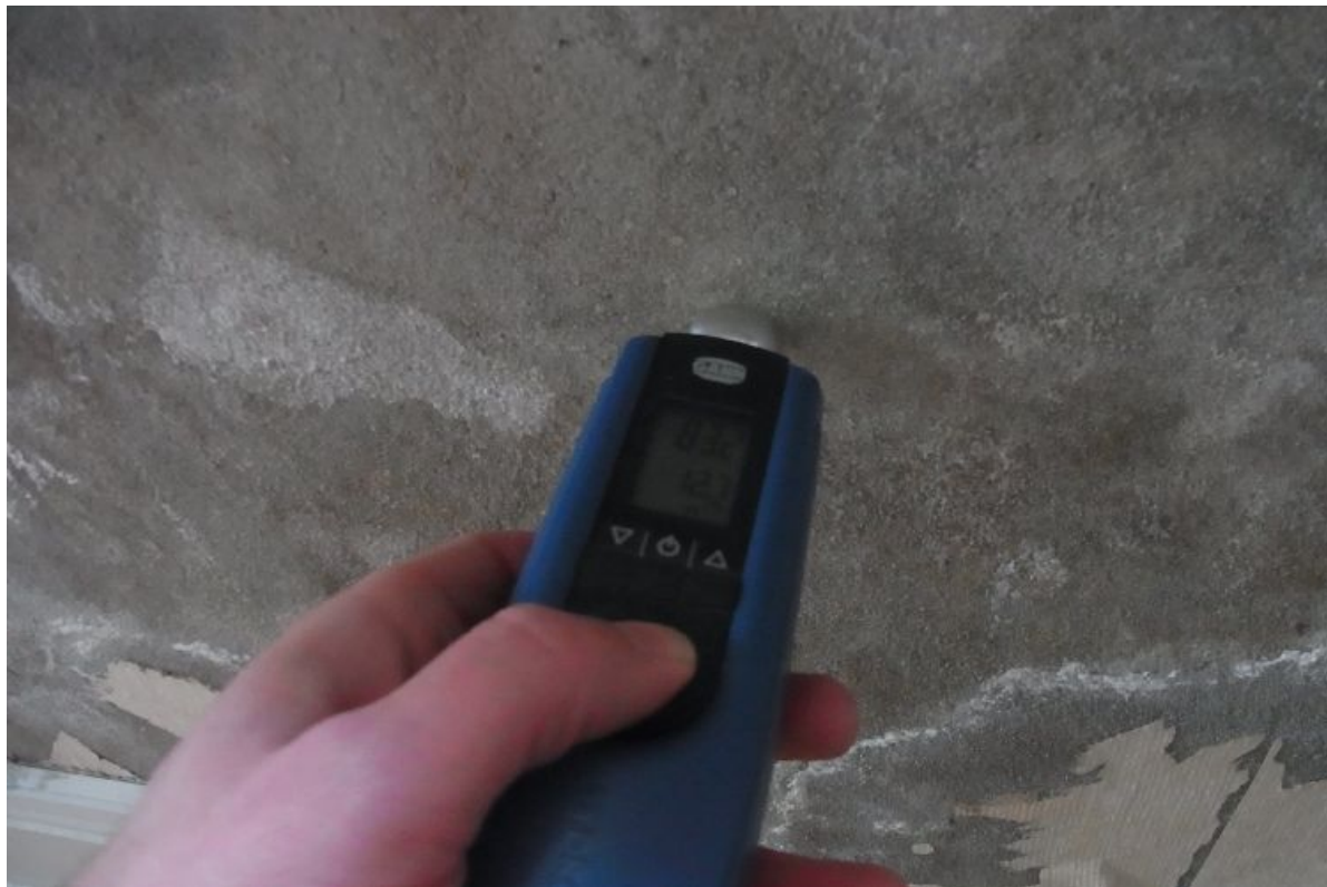
Fugtmåling på 81 digits i brystning under sydvendt vindue, stue
