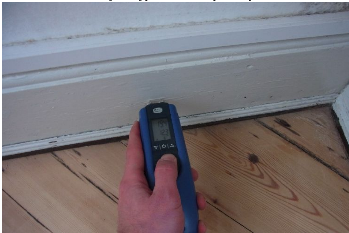
Fugtmåling på 19% i gulvpanel, karnap
