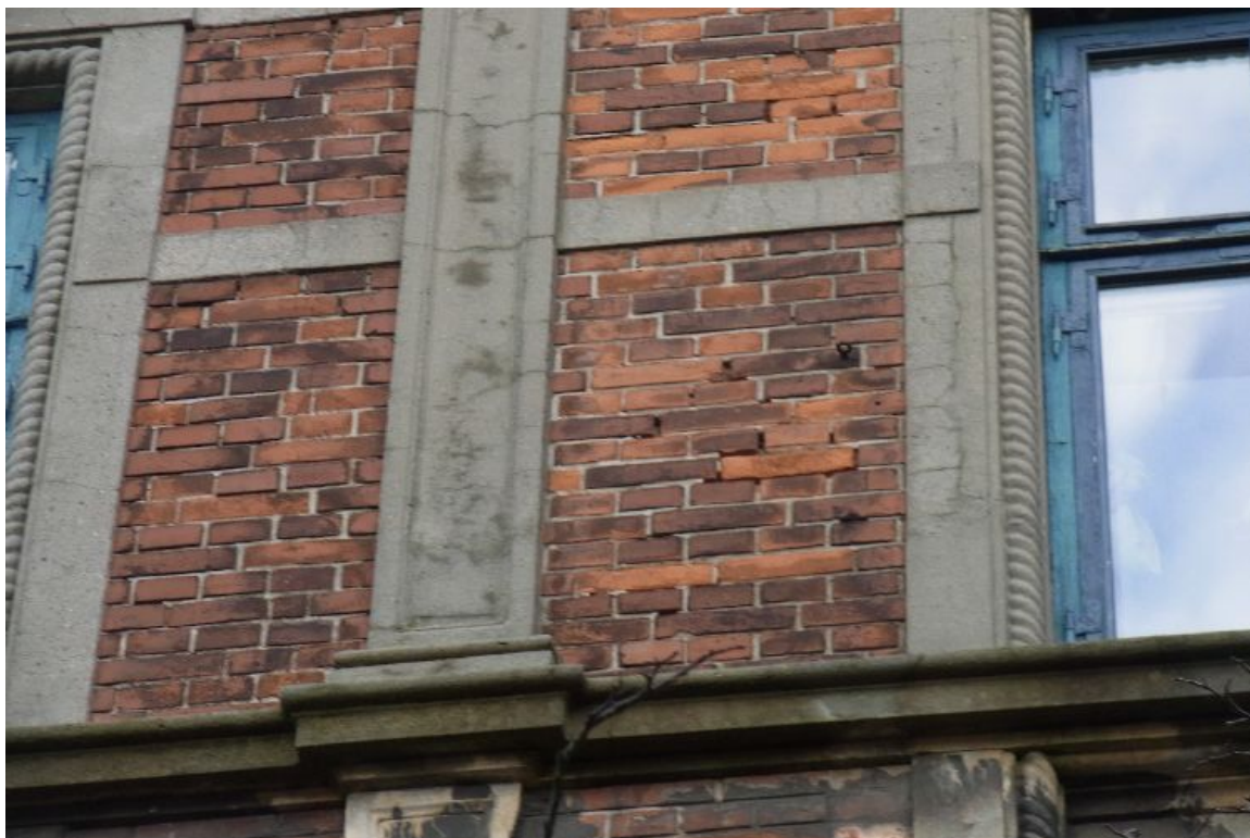
Forvitret murværk og manglende fuger
