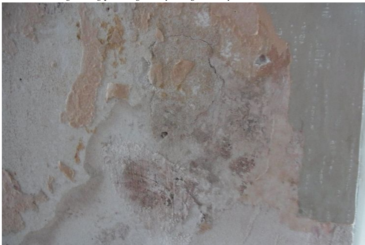
Skimmelvækst på brystning under sydvendt vindue, stue
