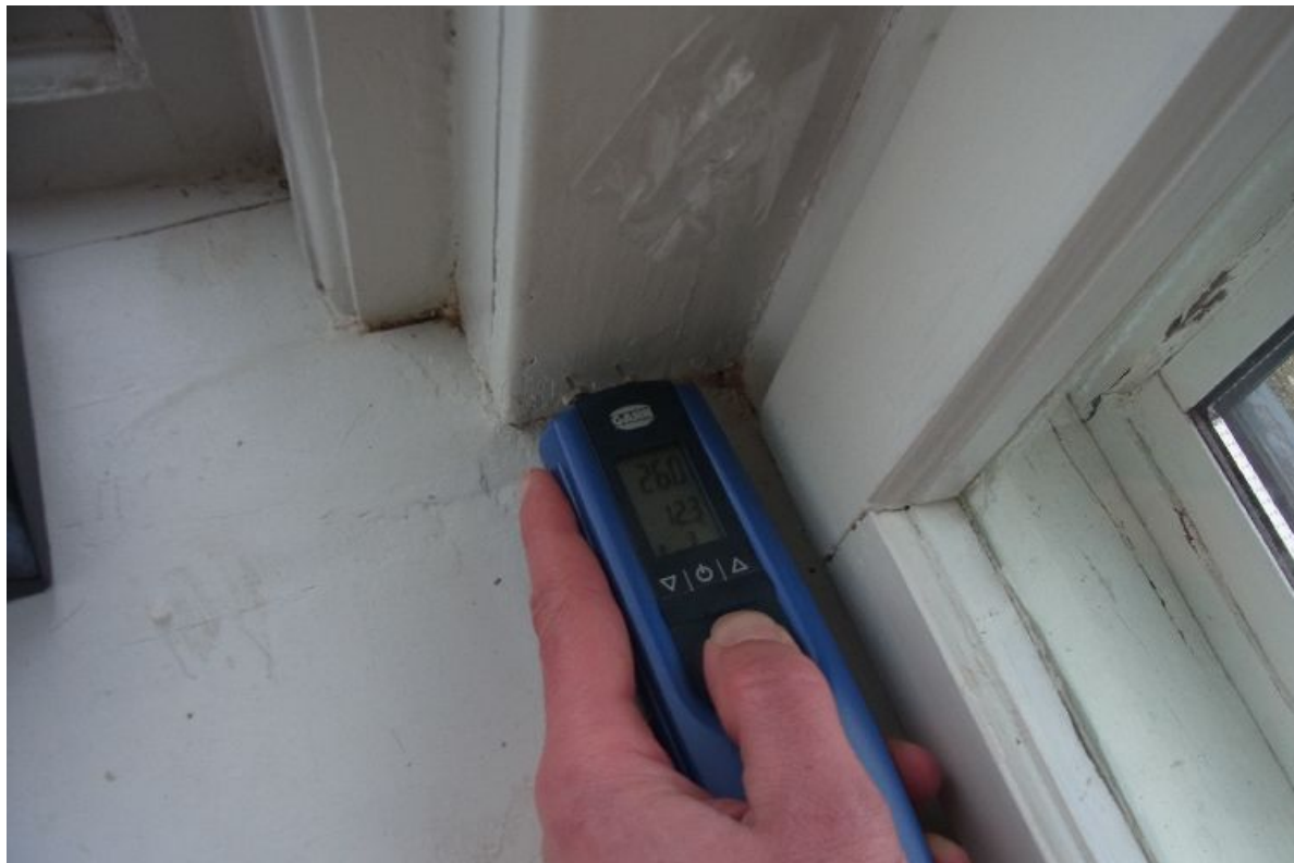
Fugtmåling på 26% i karmstolpe, karnap
