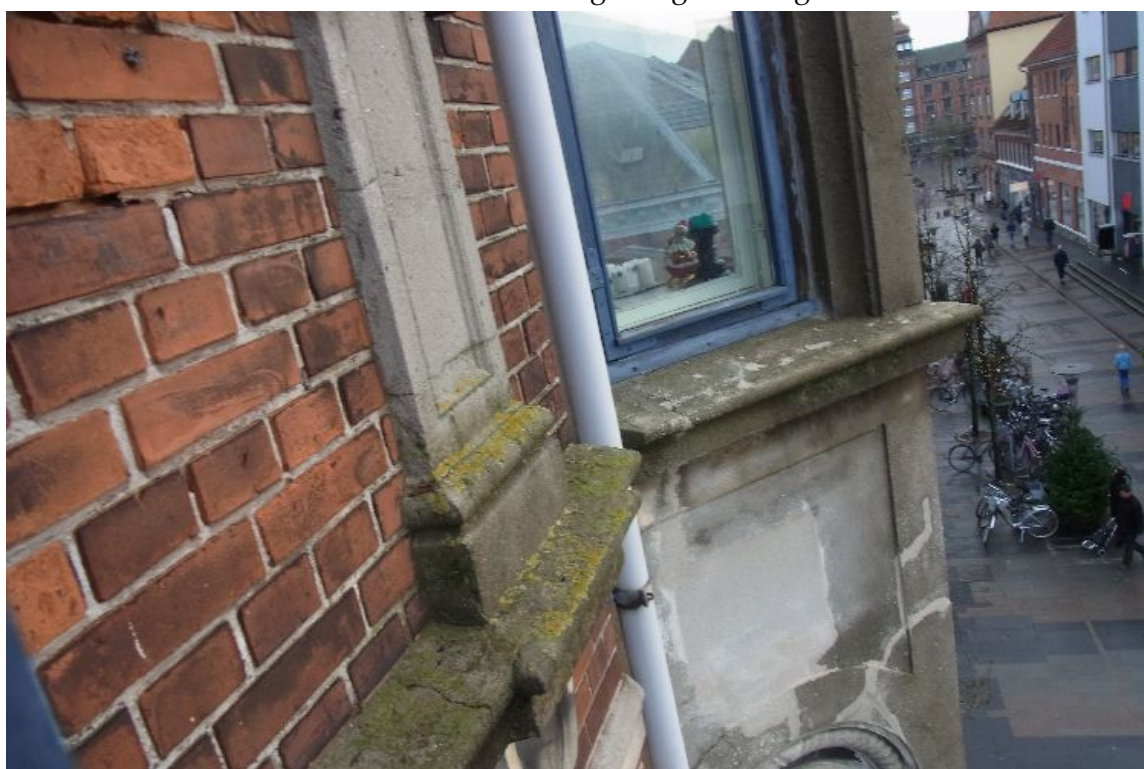
Revner i sålbænk og forvitret murværk
