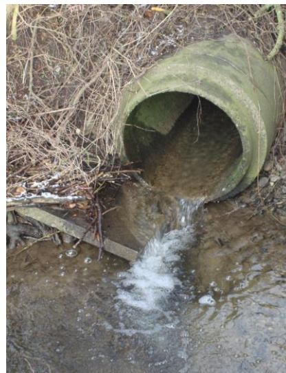
Tilløb til Gammelby Mølleå, rørlagt strækning med niveauspring ved udløb i Gammelby Mølleå
