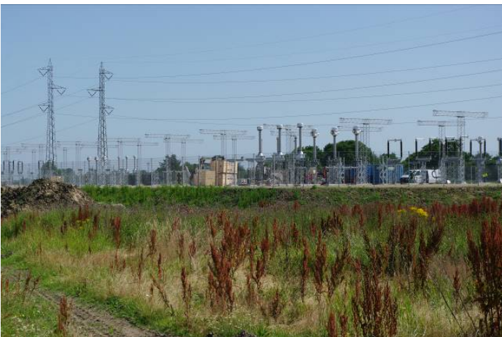
EnerginetDK's nyetablerede transformatorstation i områdets sydlige del.
