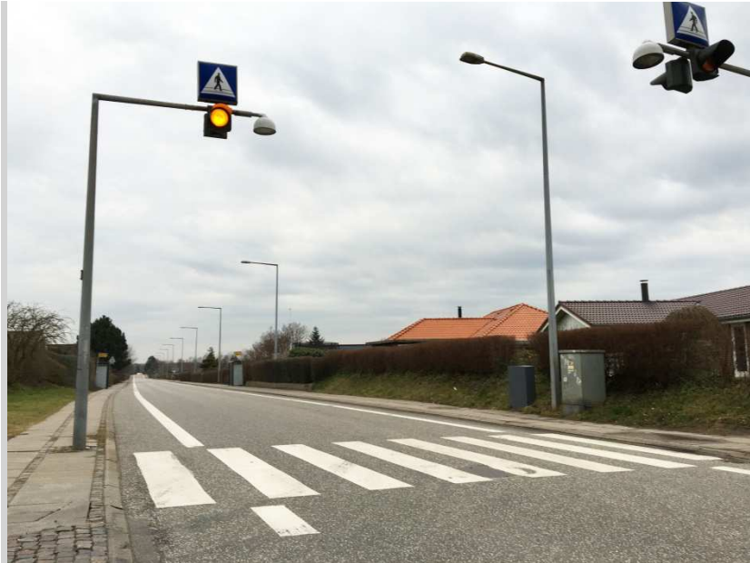
Fodgængerfelt med belysning og toronto anlæg,
