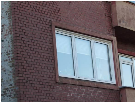
#5 Nærfoto af beton-”ramme” omkring vinduer. Bemærk vandret fremspring i forhold til murstenene.
