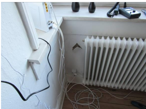
#41 Stue - Måling af vest-facade. Åbning af fugtig og løstsiddende tapet under vinduesparti.
