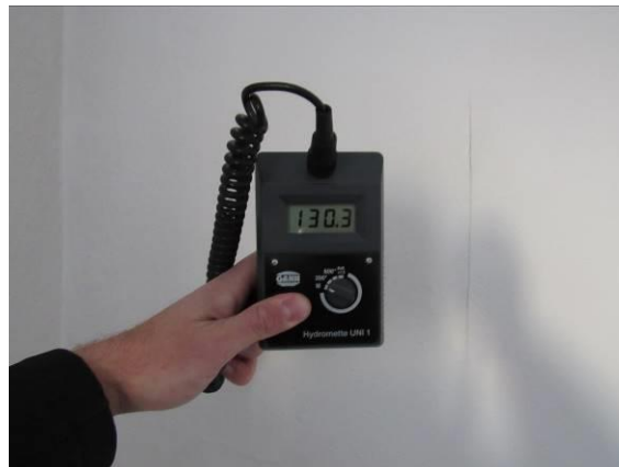
#38 Måling af nord-væg, ca. 0,3m fra opfugtet vest-væg viste 130 Gann digits (meget opfugtet). Fugtmålinger aftog med afstanden til vest-væg.
