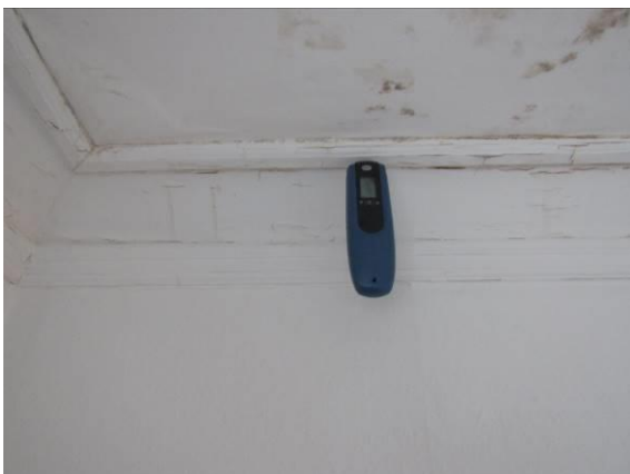
#23 Fugtmåling af træstuk i misfarvet område.
