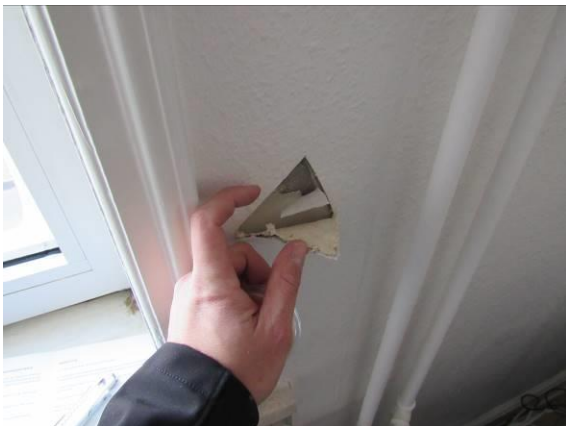
#33 Stue – Måling af vest-facade. Højre del af vinduespartiet. Åbning i løstsiddende tapet.
