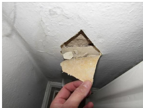
#42 Løstsiddende fugtig tapet, og meget porøst puds. Prøverne P/T7 blev udtaget på misfarvet bagside af tapet.
