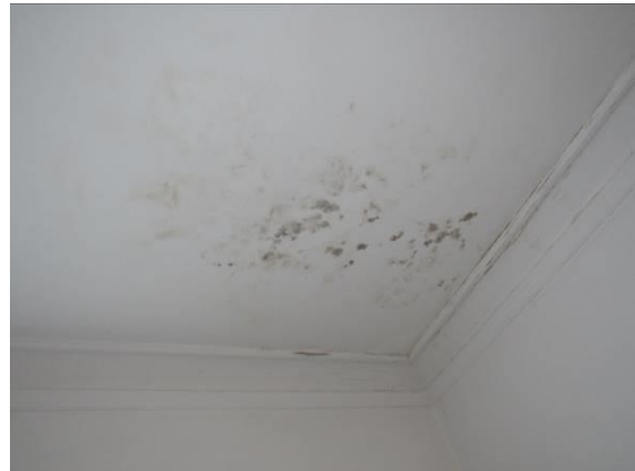
#20 Misfarvninger på loftet af skimmelig karakter.
