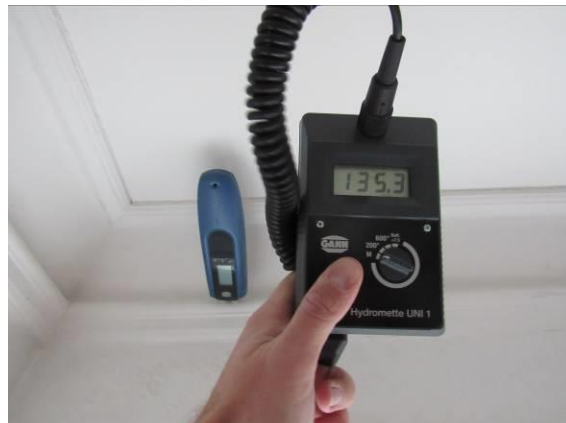
#26 Fugtmåling af træstuk viste >21 % træfugt. Fugtmåling af tung væg/overligger viste 135 Gann digits (kraftigt opfugtet).
