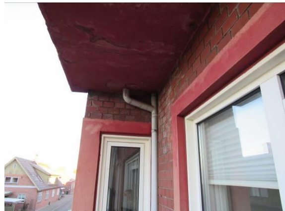
#6 Foto af underside af altan.
