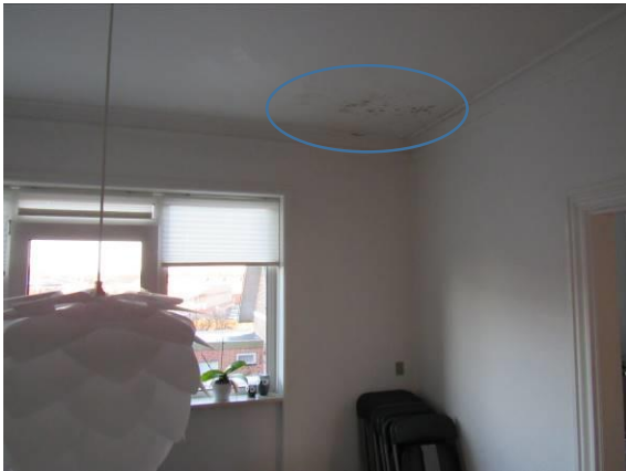
#19 Stue – Område med misfarvninger på loftet ved altan.
