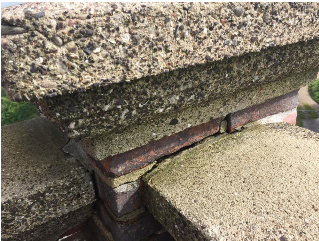
Manglende fuger i murværk, ovenliggende altan
