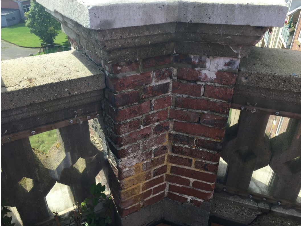
Manglende fuger, ovenliggende altan
