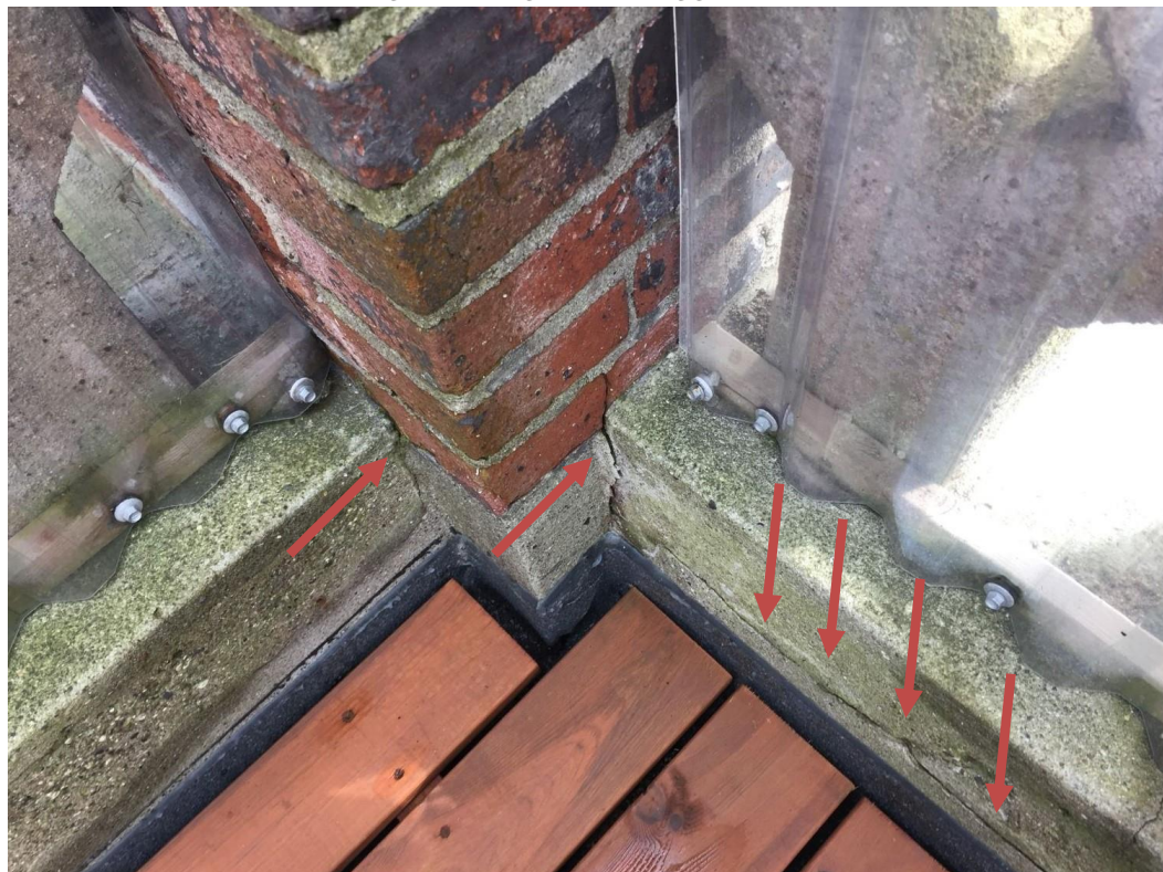
Revner i murværk, ovenliggende altan
