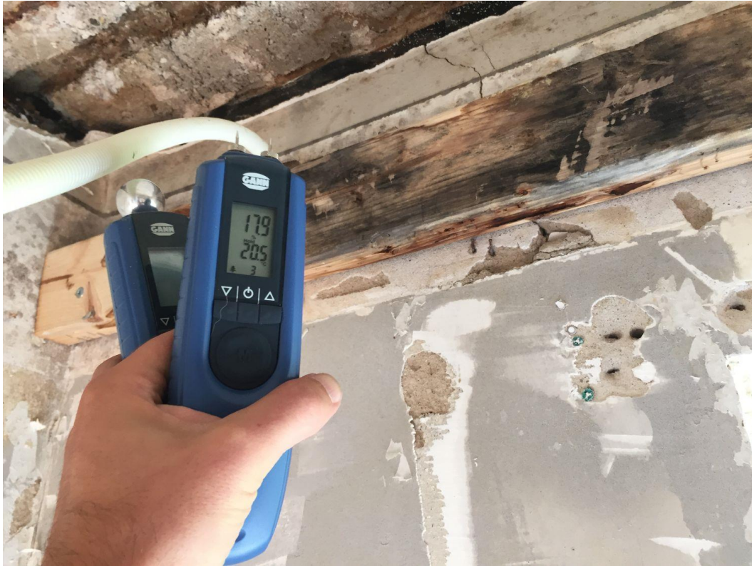
Forhøjet fugtindhold i top af ydervægge – Aftrykssted nr. 1
