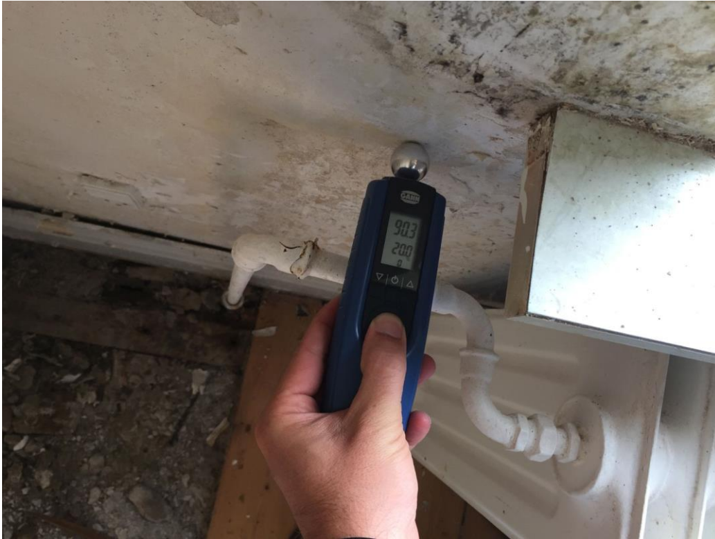
Skimmelbegroninger og lokal opfugtning i murværk ved vindue
