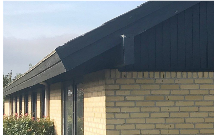
Billede: Eksempel på murrem af træ. Her ført ud over tagkanten i gavlen.
