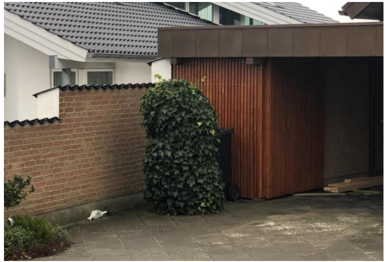
Kærmosevej 22 har Carport/skur i Skel, med fald i terræn
