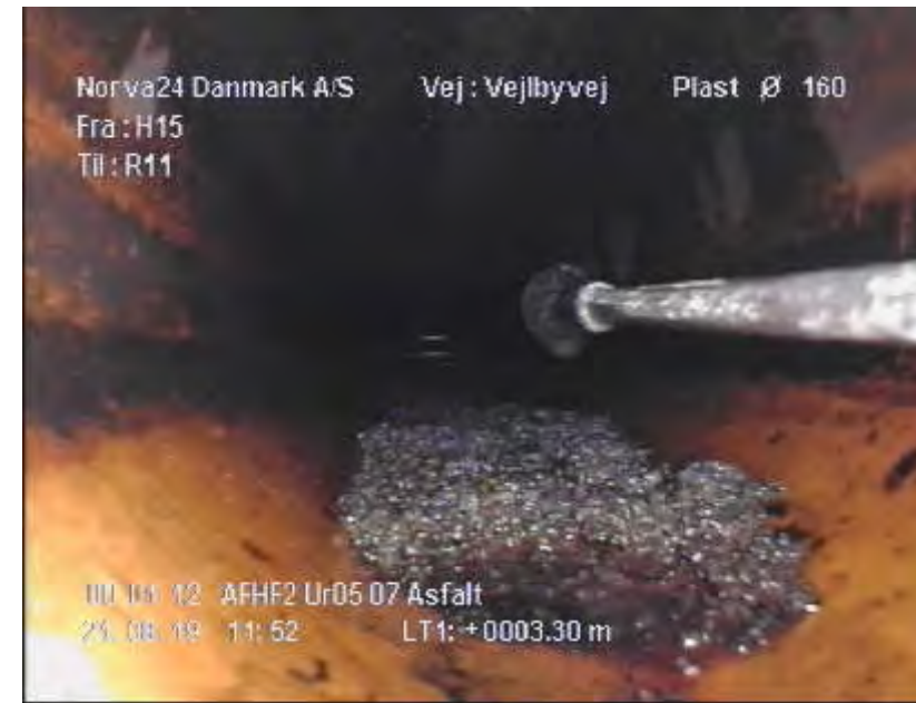
FOTO 006 00:00:58 3.3 m AFHF 2 Asfalt
