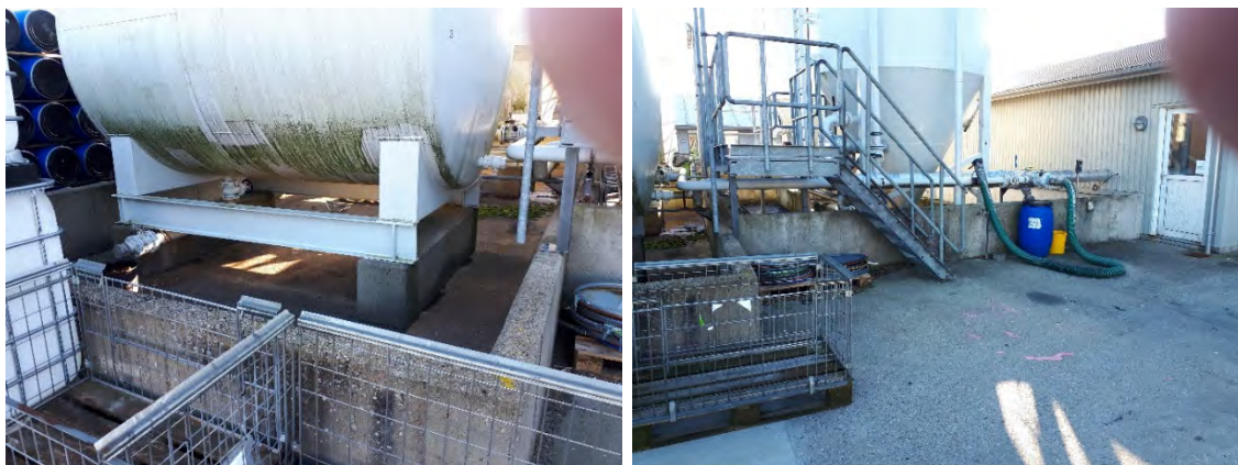
Figur 7-4 Tankgård med opsamlingsbassin. Til højre ses tætsluttende slange, som kobles til tankene ved påfyldning
