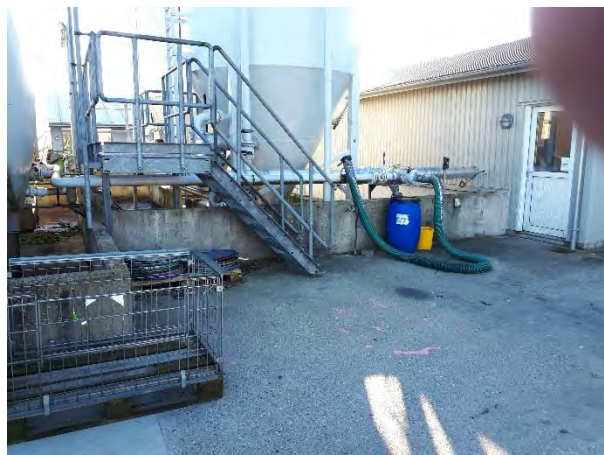
Foto 14: Tankgård med tætsluttende slange som kobles til tankene
