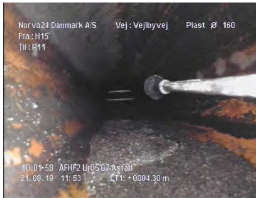
FOTO 007 00:01:49 4.3 m AFHF 2 Asfalt
