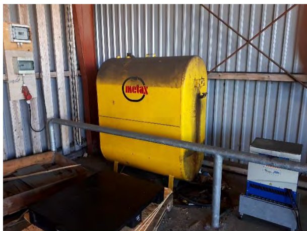
Foto 1: Tidligere oiletank, ikke i brug. Ingen tegn på spild under tank
