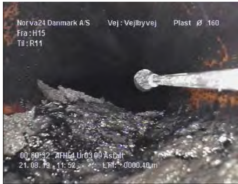
FOTO 005 00:00:21 0.4 m AFHF 4 Asfalt
