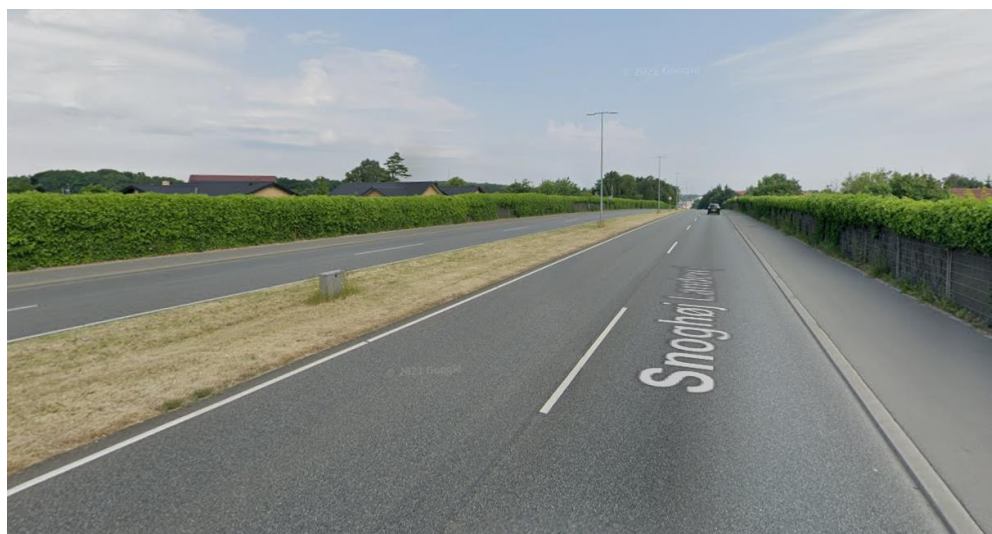
Figur 10-3: Udseende af Snoghøj landevej mellem Erritsø Bygade og Røde Banke. Kilde: Google Street view.
